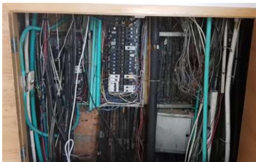
Ilustración 3. Ubicación y estado de los tableros de distribución en pisos
